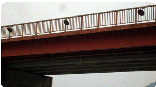
電波式流速計 (横断方向多点設置)
