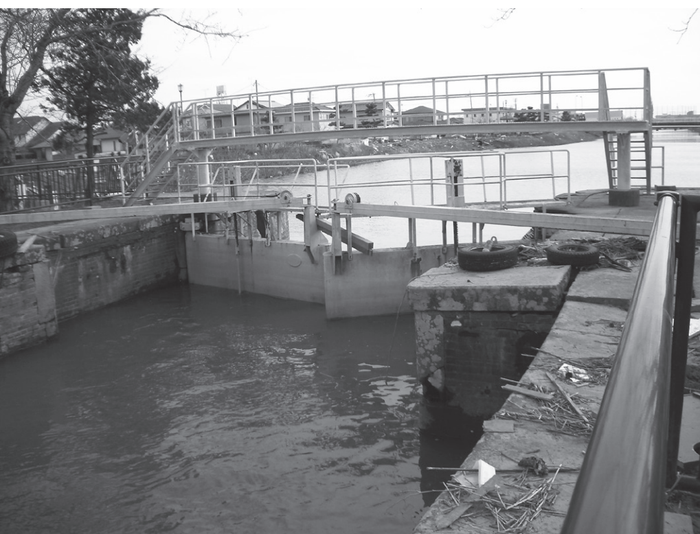
写真1 被災した石井閘門（閘尾部側 撮影：2011年3月14日）
