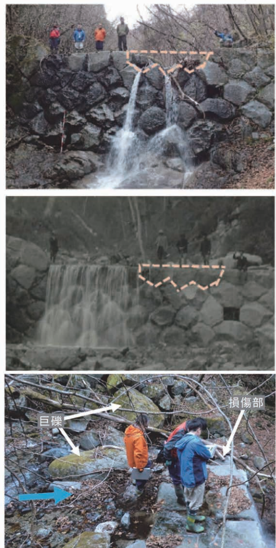
図-13 金山沢第3号堰堤（上：2015（平成27）年12月撮影，中：諸戸アルバムより，1932（昭和7）年5月撮影，下：水通し部の巨礫，2015（平成27）年12月撮影）
