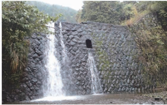
図一五 湯船沢堰堤 (2014 (平成 26) 年 11 月撮影, 水通し部の右岸側最上段の石材が流失している) Fig.5 Yufunezawa check dam (Taken in 2014)
