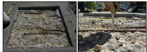
写真-1 床版上面の損傷状況(前回点検時)
