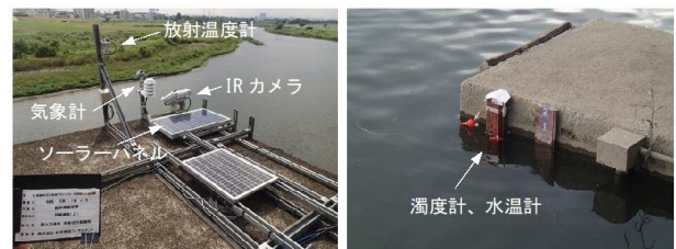
図-4 実河川機器設置状況
