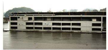
須崎港陸閘(高知県)
